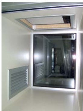
Cleanroom: passa materiali lussato ed interbloccato
